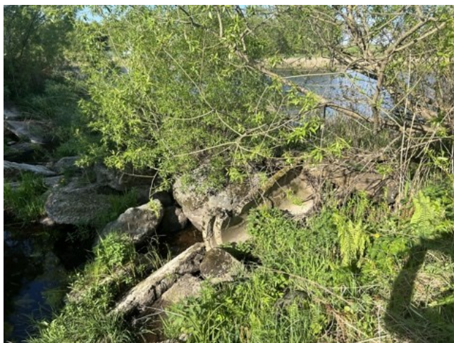
Рис. 2. Разрушенное водосбросное сооружение
