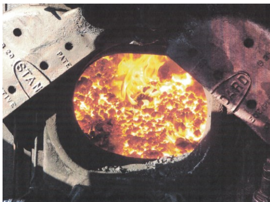
Рис. 1. Горение твердого топлива на колосниковой решетке в ТПК
