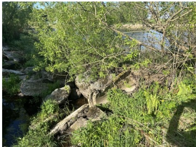
Рис. 2. Разрушенное водосбросное сооружение
