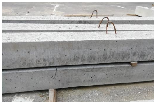
Рис. 2. Неправильное складирование перемычек
