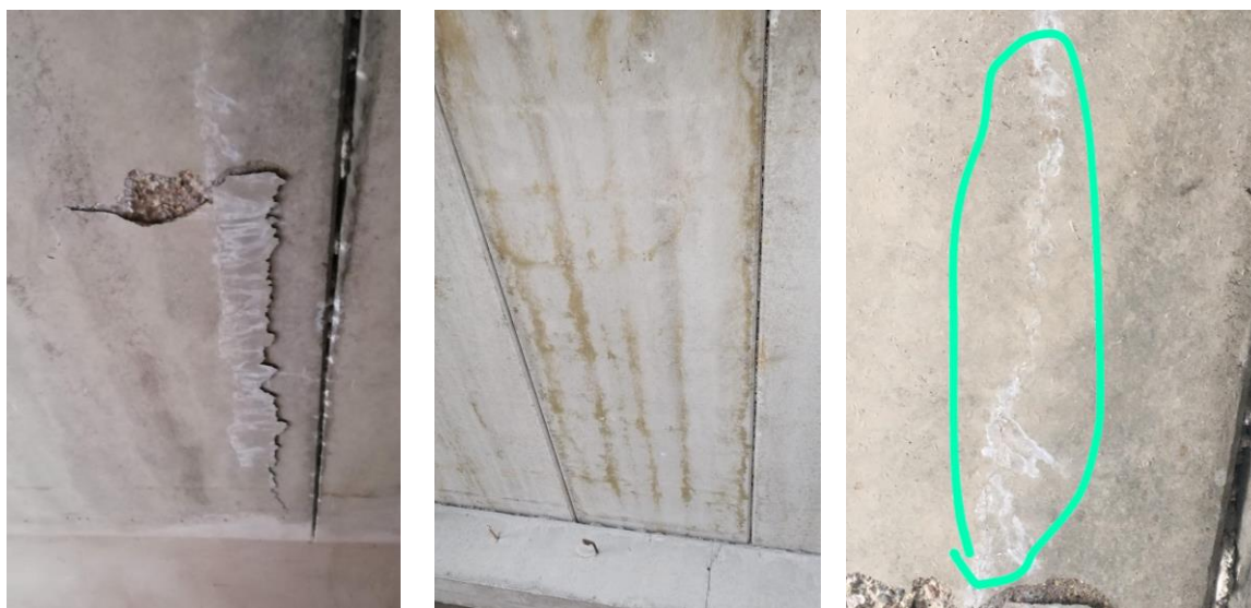
Рис. 6. Дефекты на многопустотных плитах перекрытий после монтажа
