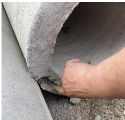
Рис. 3. Неправильная перевозка труб
