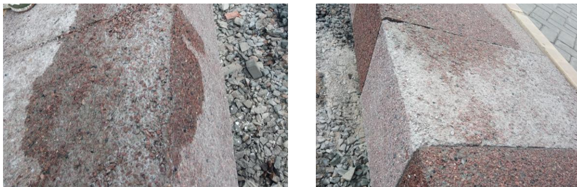
Рис. 8. Разрушение угловых элементов платформ
