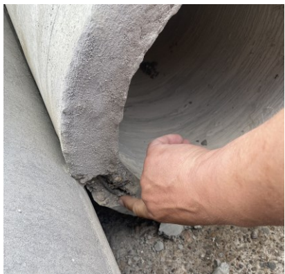
Рис. 3. Неправильная перевозка труб
