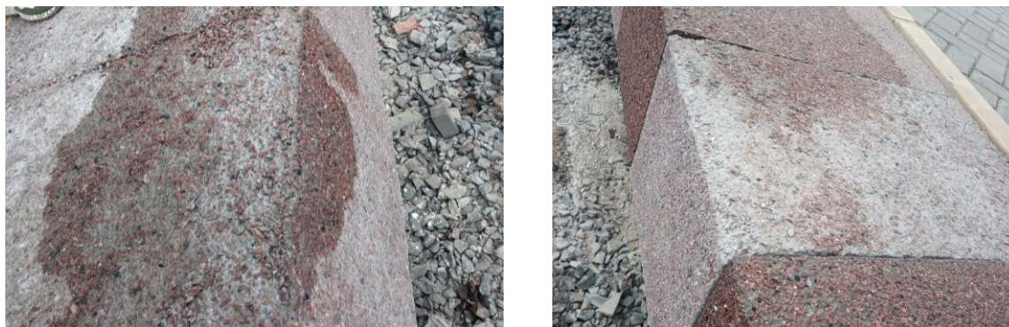
Рис. 8. Разрушение угловых элементов платформ
