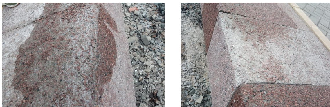
Рис. 8. Разрушение угловых элементов платформ
