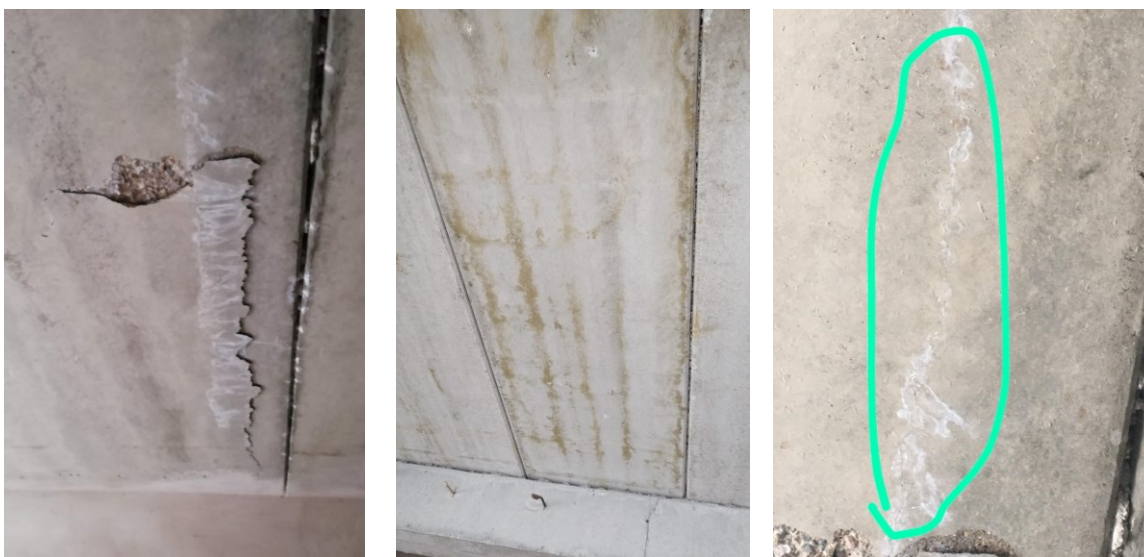
Рис. 6. Дефекты на многопустотных плитах перекрытий после монтажа
