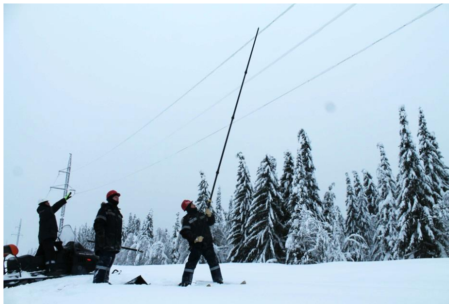
Рис. 3. Сбивание наледи с проводов ЛЭП [1]
