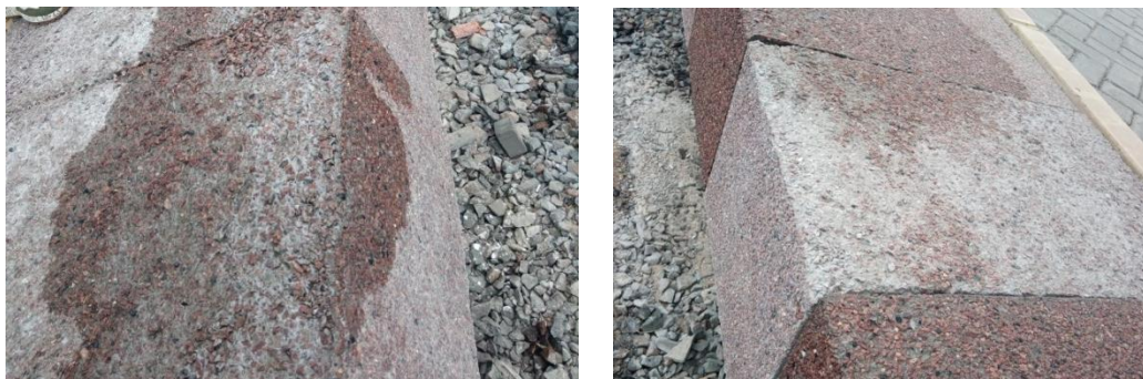
Рис. 4. Разрушение бетона под действием противогололедных реагентов
