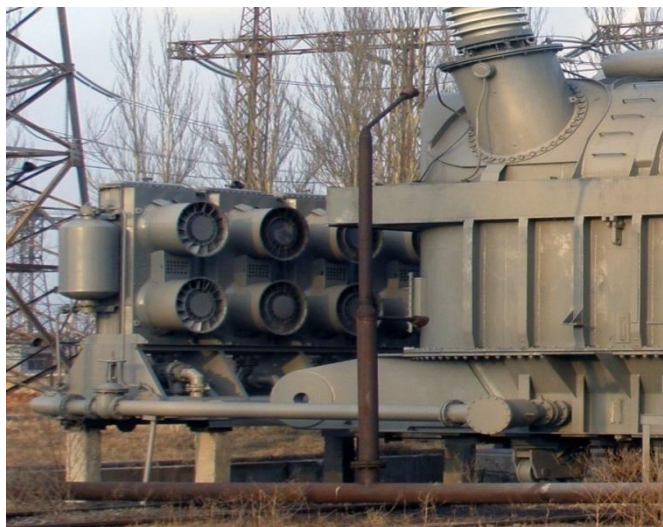
Рис. 3. Общий вид системы охлаждения трансформатора типа ДЦ
