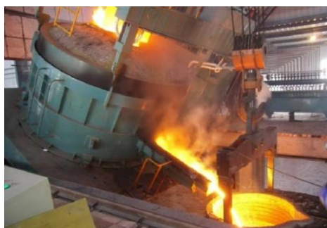
Рис. 1. Дуговая сталеплавильная печь вместимостью 6 т металла
