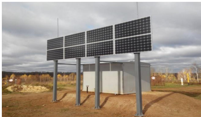
Рис. 1. Конструкция для установки КП ТМ с солнечными модулями (Брянская область)
